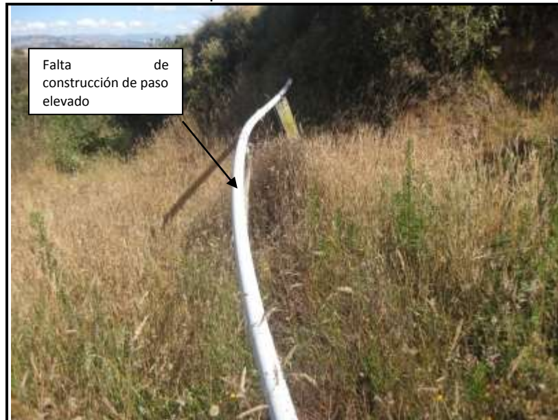
Grafico 20. Falta la construcción del paso elevado N: 1099329 E: 1082601.
