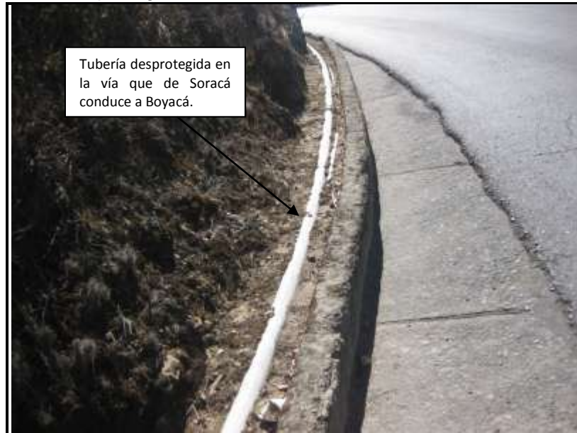
Grafico 21. Tubería desprotegida N: 1099250 E: 1082650
